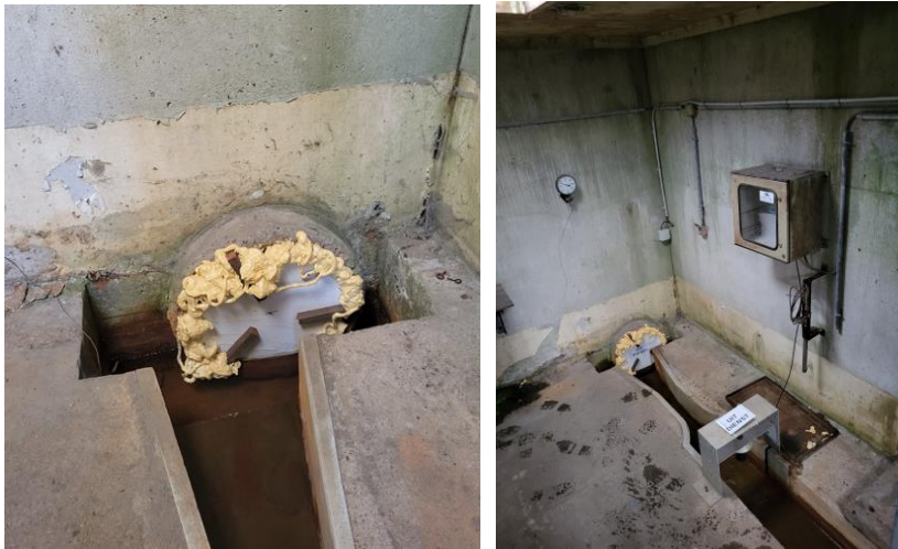
Figuur 7 - De oude leiding die naar het lozingspunt leidt, is afgesloten en de bijhorende meter bevindt zich aan de muur. (TWZ,2026)
