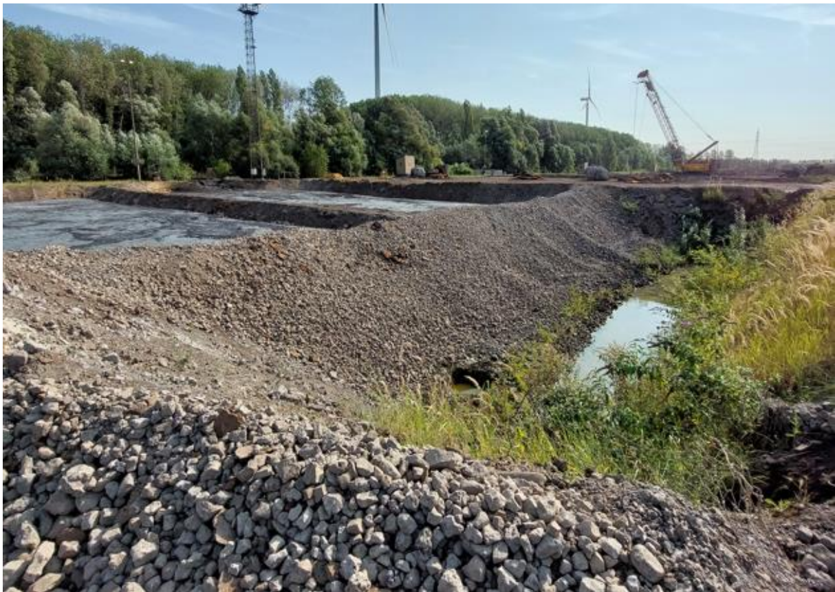
Figuur 2-3: Draineerput van noodruwizerput 9 en 10.
