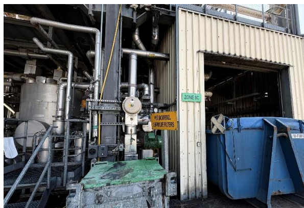
Pomp bij biodieselfiltratie
