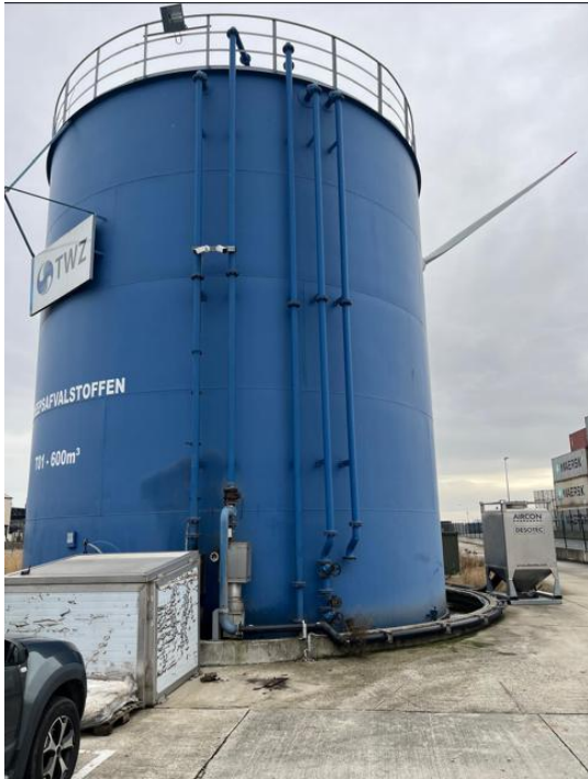
Figuur 5. Foto Tank 01 met behandeling van ontluuchting via actief koolfilter [Foto geuraudit 2026]
