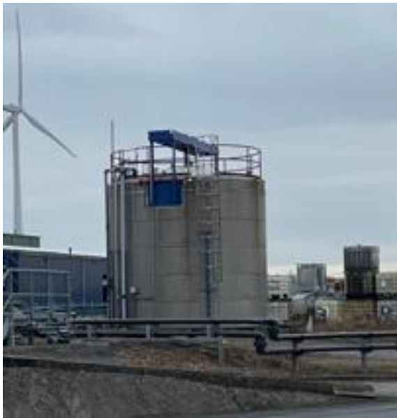
Figuur 4. Foto opslagtank T17 [Foto geuraudit 2026]
