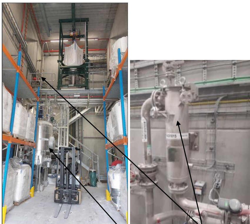
Figuur 3 Storttrechter bigbags en mengtank (links), luchtfilter op mengtank (rechts)
