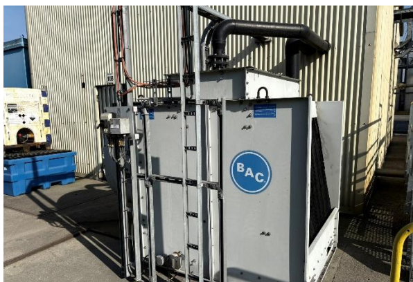
Aanzuig koeltoren effluent WZ (BAC)
