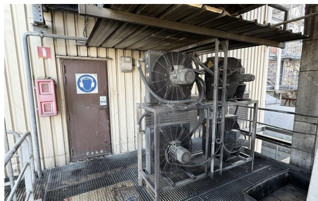
Blowers oliekoeling perserij
