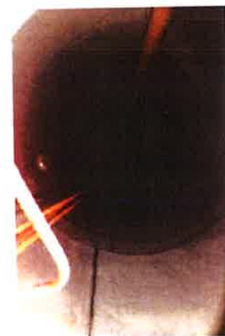
Figuur 6: Tankbodem met verwarmingsspiraal gezien vanuit mangat
