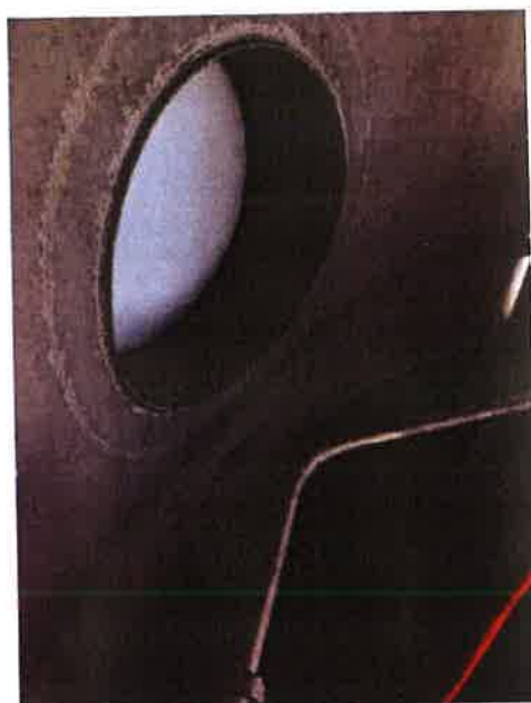
Figuur 4: Dichtgelaste mangat onderaan tank
