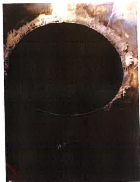
Figuur 4: Dichtgelaste mangat onderaan tank
