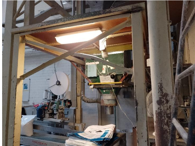
FIGUUR 8 TL VERLICHTING IN TECHNISCHE RUIMTE
