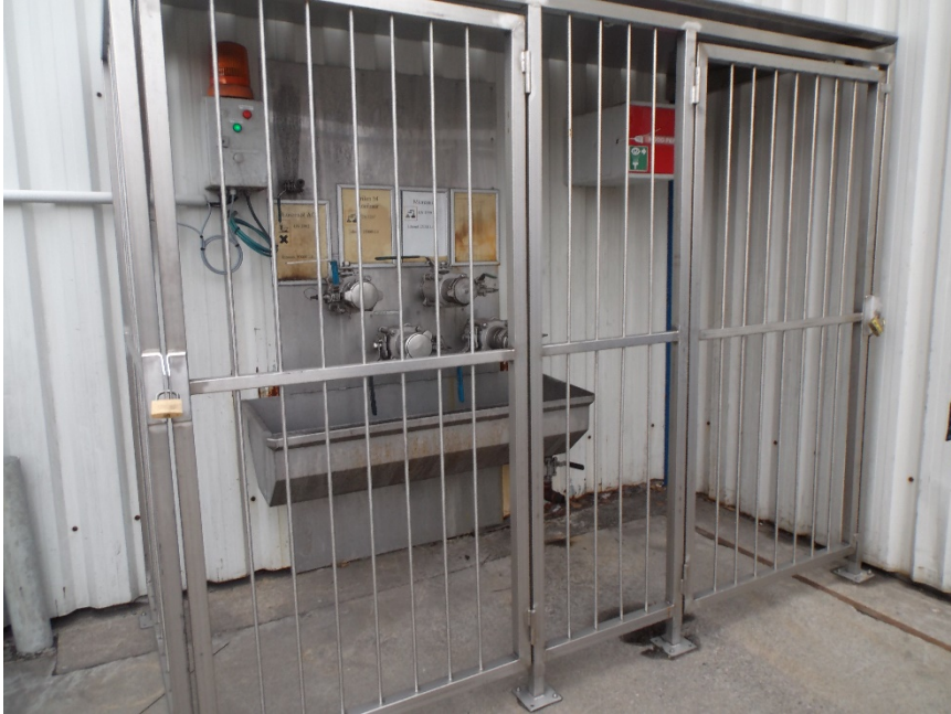
Figuur 1: Aansluitpunt voor laden en lossen van vloeibare producten met hekken, lekbak en zwaailamp
