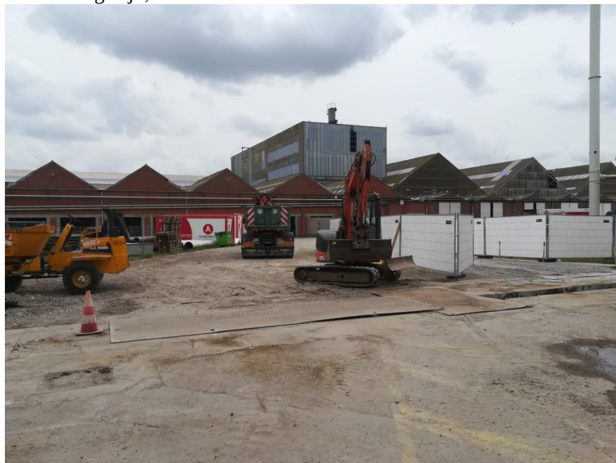
Foto F25: zone Z24: groenzone ter hoogte van voormalig beendermagazijn, nu werfzone: asbestverdacht
