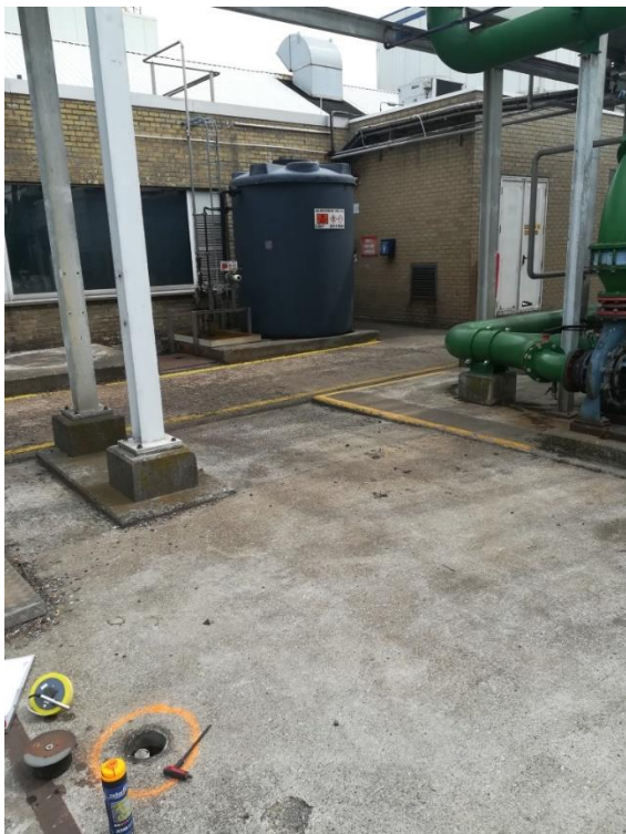
Foto F5: zone Z4: Bovengrondse \text{HNO}_3 -tank 4,015 m 3 (R40) en voormalige bovengrondse \text{HCl} -tank 5,5 m 3 (R39), zone Z5: Bovengrondse \text{NH}_3 -tank 12 m 3 (R38) (P504)
