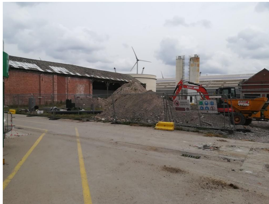
Foto F24: Zone Z24: Groenzone ter hoogte van voormalig beendermagazijn, nu werfzone: asbestverdacht
