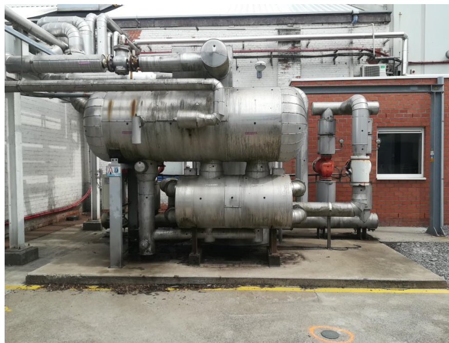
Foto F18: Zone Z19: Opslag van glycolen en bovengrondse NaOCl-tank 1,0 m 3 (R47) (zicht op peilbuis P15005)
