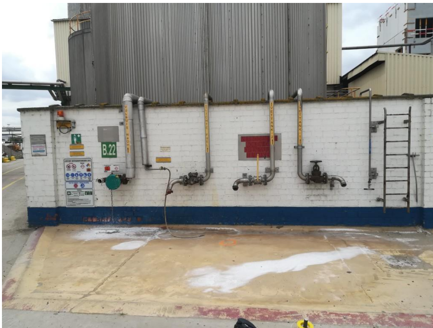
Foto F3: zone Z2: Twee voormalige bovengrondse zware stookolietanks 2 x 200 m 3 (R19), bovengrondse tank met dierlijk vet 385 m 3 , bovengrondse dieseltank 1 000 l en bovengrondse NaOH-tank 60 m 3 (R37)
