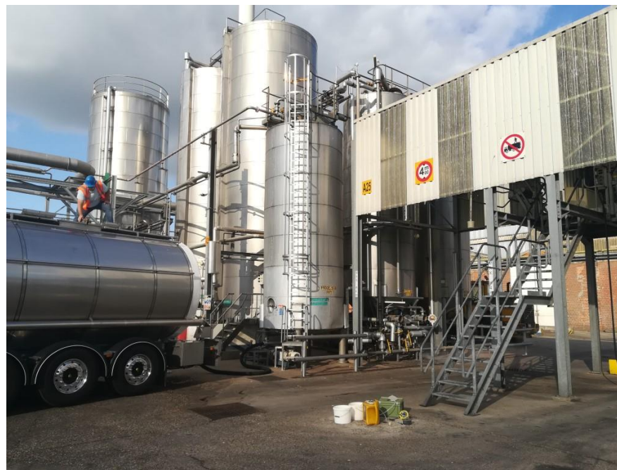
Foto F10: Zone Z9: Voormalige likeuroplossingtanks 2 x 50 m 3 en 2 x 100 m 3 en voormalige bovengrondse ammoniumtank 40,5 m 3 (T5) – huidige opslag van vet en progel (P19004)
