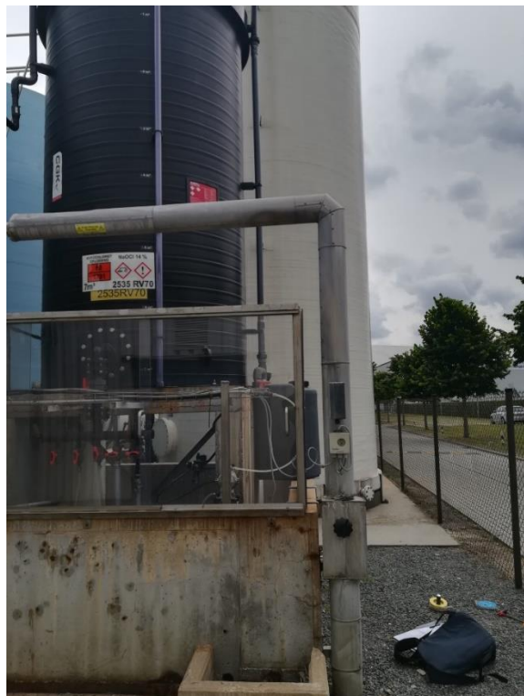
Foto F9: Zone Z8: Voormalige bovengrondse NaOCl-tank 5,05 m 3 (R31) en huidige bovengrondse NaOCl-tank van 7 m 3
