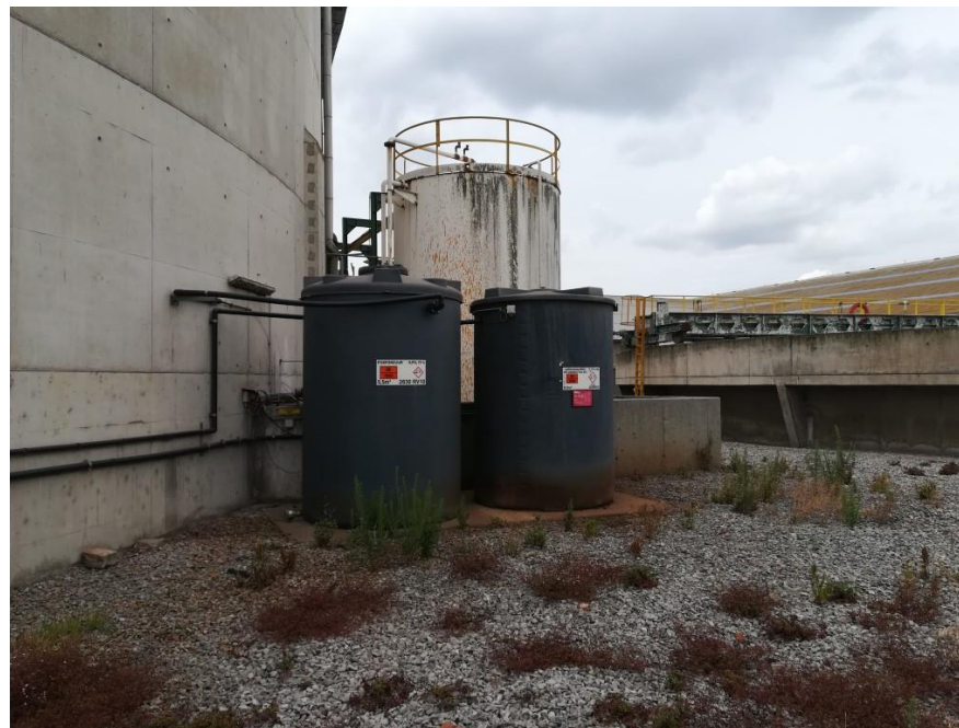
Foto F14: Zone Z14: Biologische waterzuivering met bovengrondse H 3 PO 4 -tank 5,5 m 3 (R43), FeCl 3 -tank 5,5 m 3 en HCl-tank 10 m 3 (R53)
