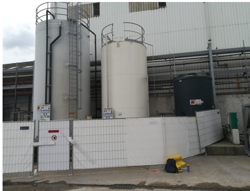
Foto F4: Zone Z3: Bovengrondse H 2 O 2 -tank 10 m 3 (R28), bovengrondse HCl-tank 70 m 3 (R54) en bovengrondse HCl/H 3 PO 4 -tank 42 m 3 (R30)
