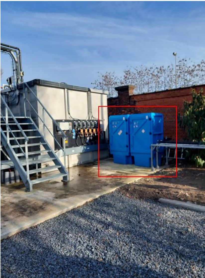
Figuur 1: Constructie voor opslag van doseerpompen voor chemicaliën
