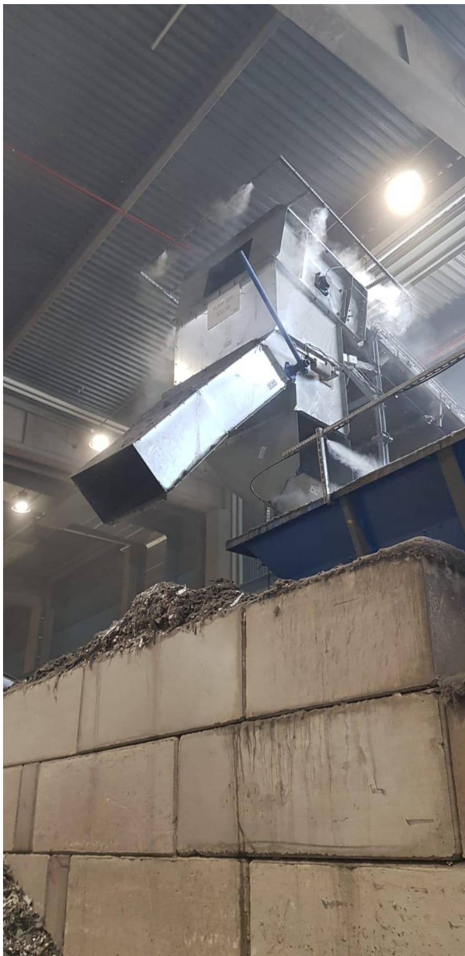
Bijlage 7_Foto frame verneveling zeefinstallatie
