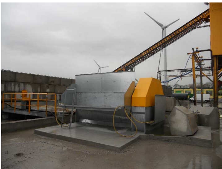
Figuur 8 Foto recyclage-installatie bij Trans -Beton NV Gent ( bron : controlebezoek 22 november 2017)
