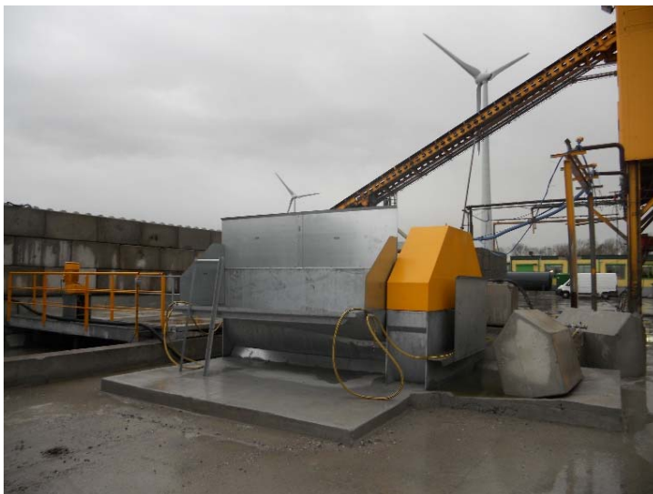
Figuur 8 Foto recyclage-installatie bij Trans -Beton NV Gent ( bron : controlebezoek 22 november 2017)
