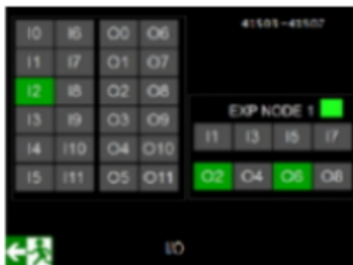
Figure 7.16 - Scherm met controllerstatus
