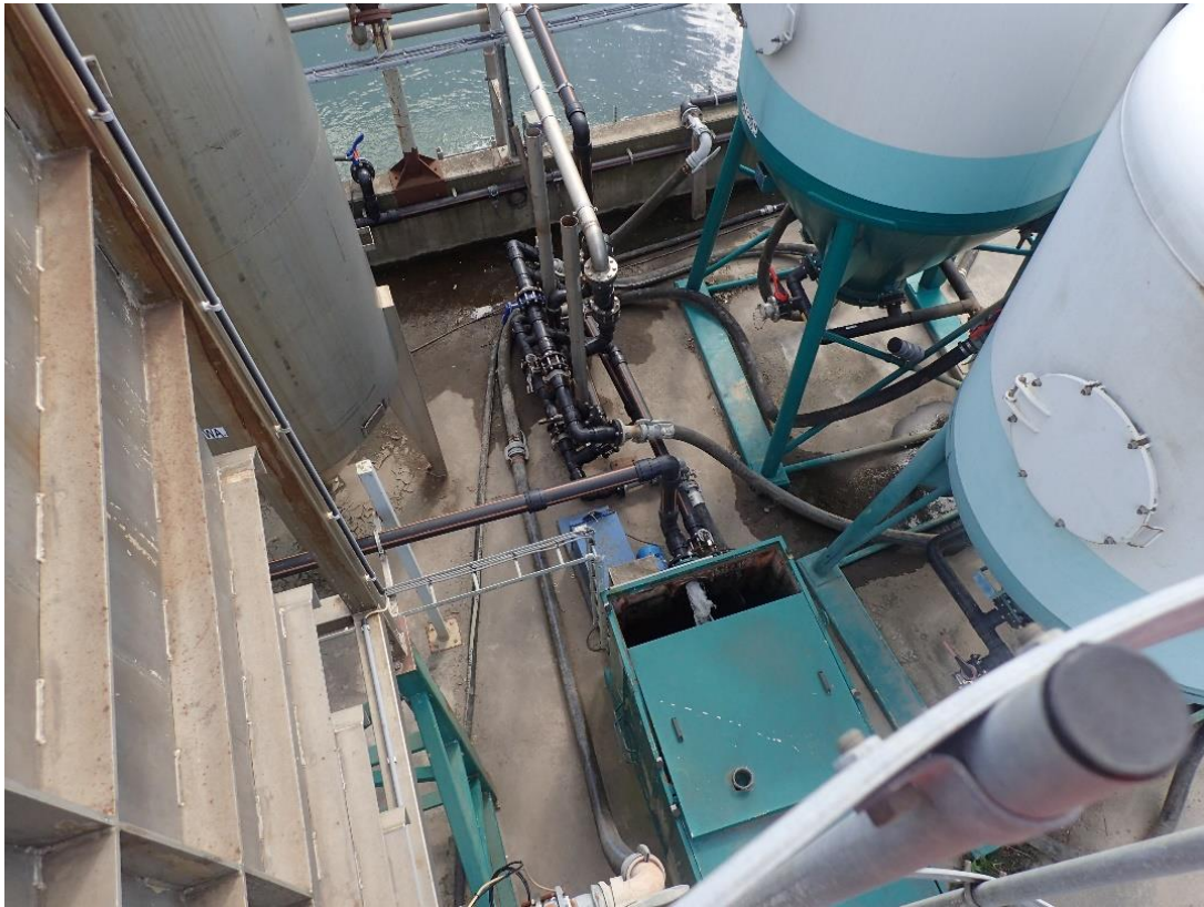
Figuur 5: Gelijkaardige waterzuiveringsinstallatie Envisan (Valorisatiecentrum Gent, site Hulsdonk) met linksboven zandfilter, centraal onderaan olie-waterafscheider en rechts twee actieve koolfilters
