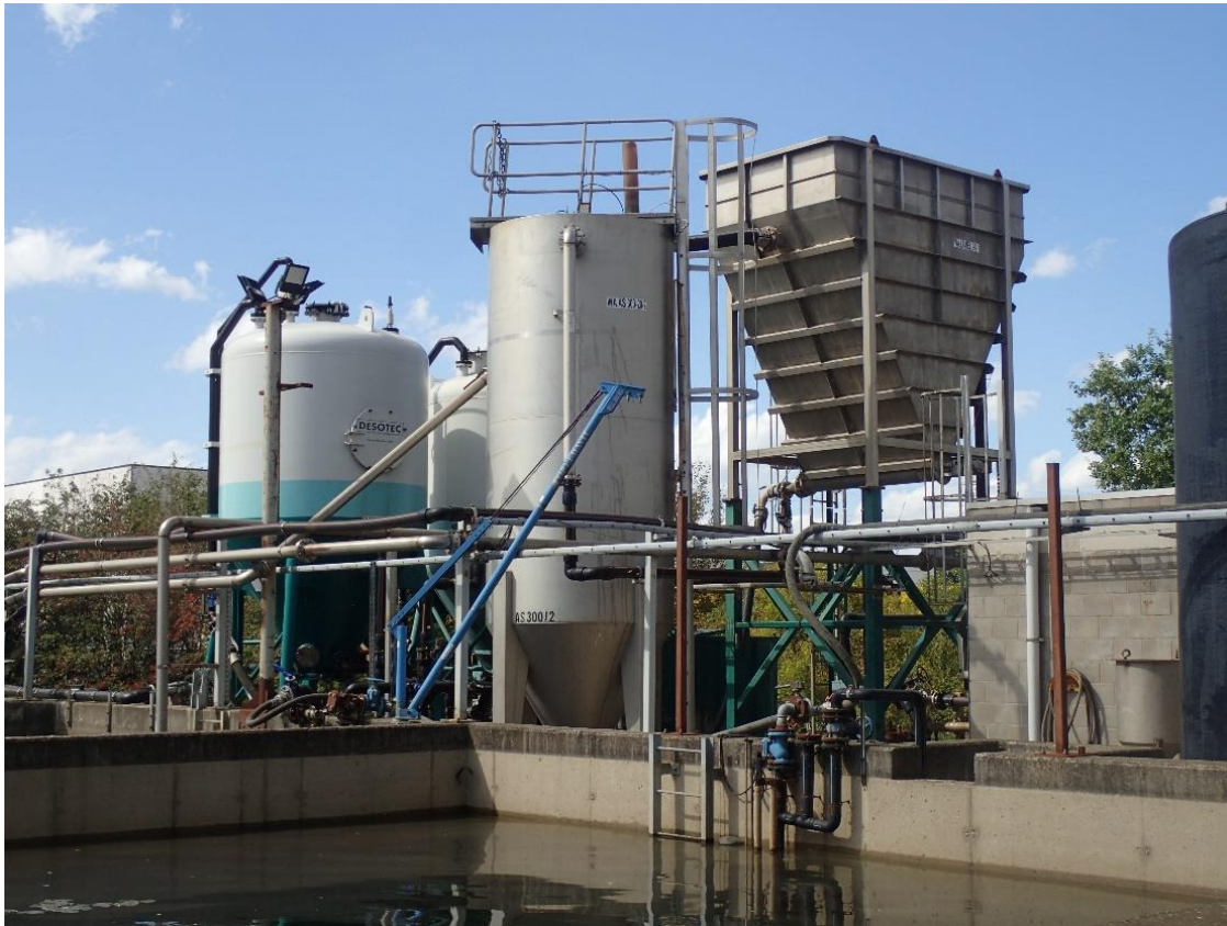
Figuur 4 : Gelijkaardige waterzuiveringsinstallatie Envisan (Valorisatiecentrum Gent, site Hulsdonk) met v.l.n.r. actieve kool filter, continue zandfilter en lamellenbezinker
