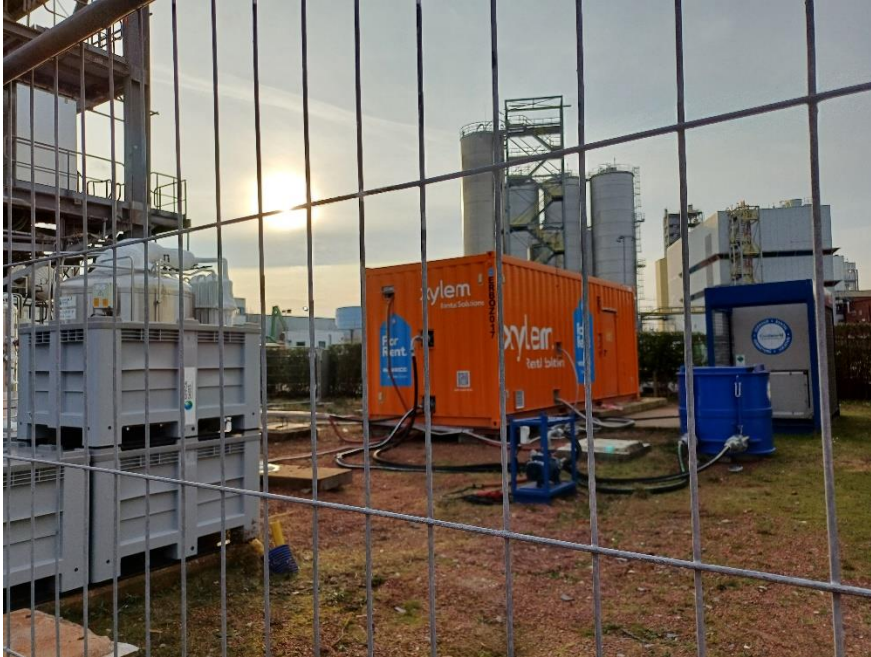
Foto 1 : containerunit met ozongenerator
