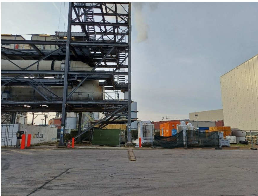
Foto 2 : opslag van vloeibare zuurstof + verdampers
