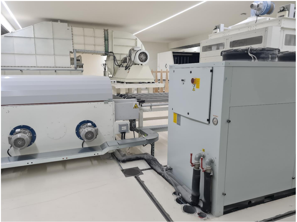
Figuur 19: Chiller zeefdrukinstallatie
