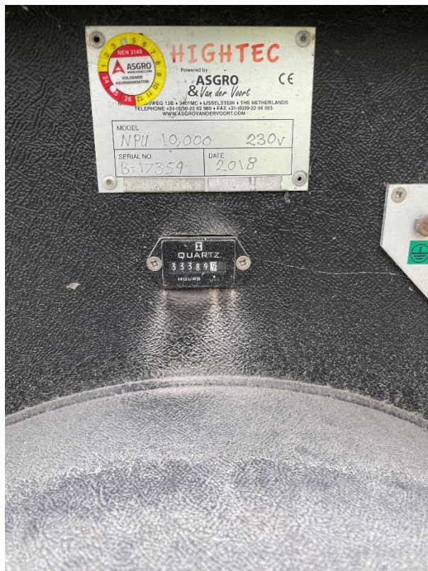
# draaiuren ventilatoren 1 en 3
