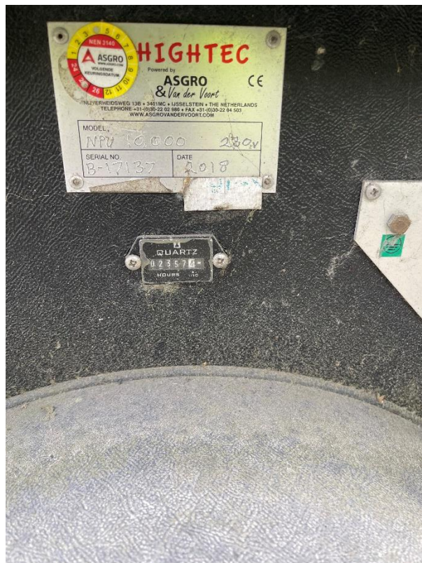
# draaiuren ventilatoren 2 en 4
