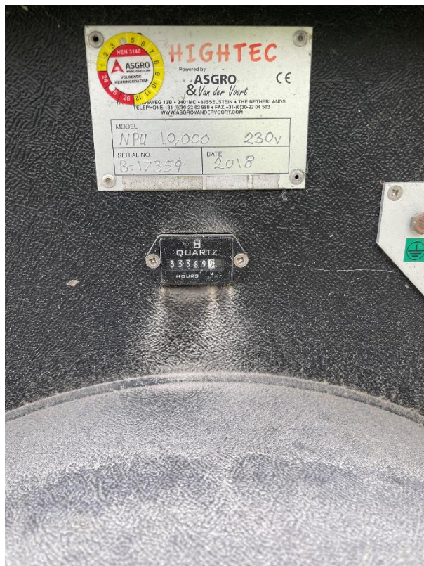
# draaiuren ventilatoren 1 en 3
