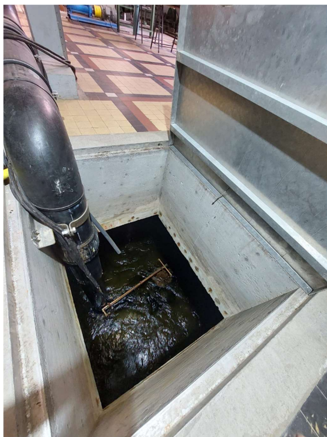
Foto 4: ondergrondse citernes met water voor labo Hydraulica (kwaliteitscontrole voorafgaand aan lozing als preventiemaatregel)
