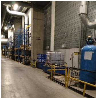
Figuur 4: Voorbeeld opslag GB2 basement
