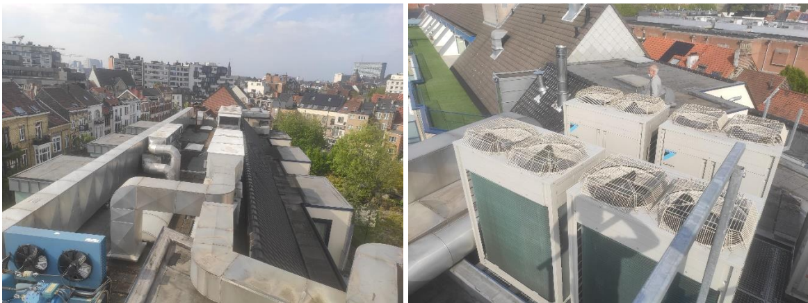
Figuur 4: koel- en afzuiginstallaties op het dak
