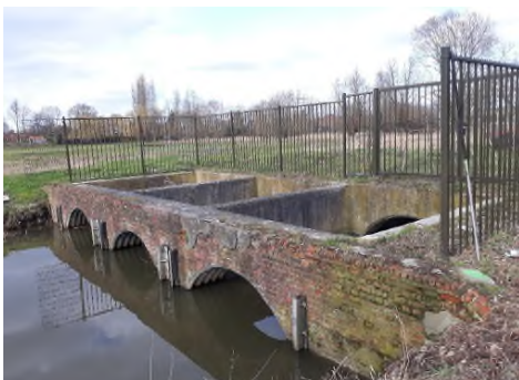
Duikers Nieuwe Kale onder R4 West en spoorweg
