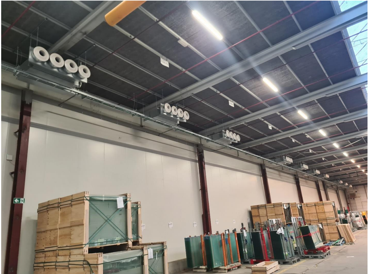
Figuur 7: Verwarming en koeling in geconditioneerde opslagplaats
