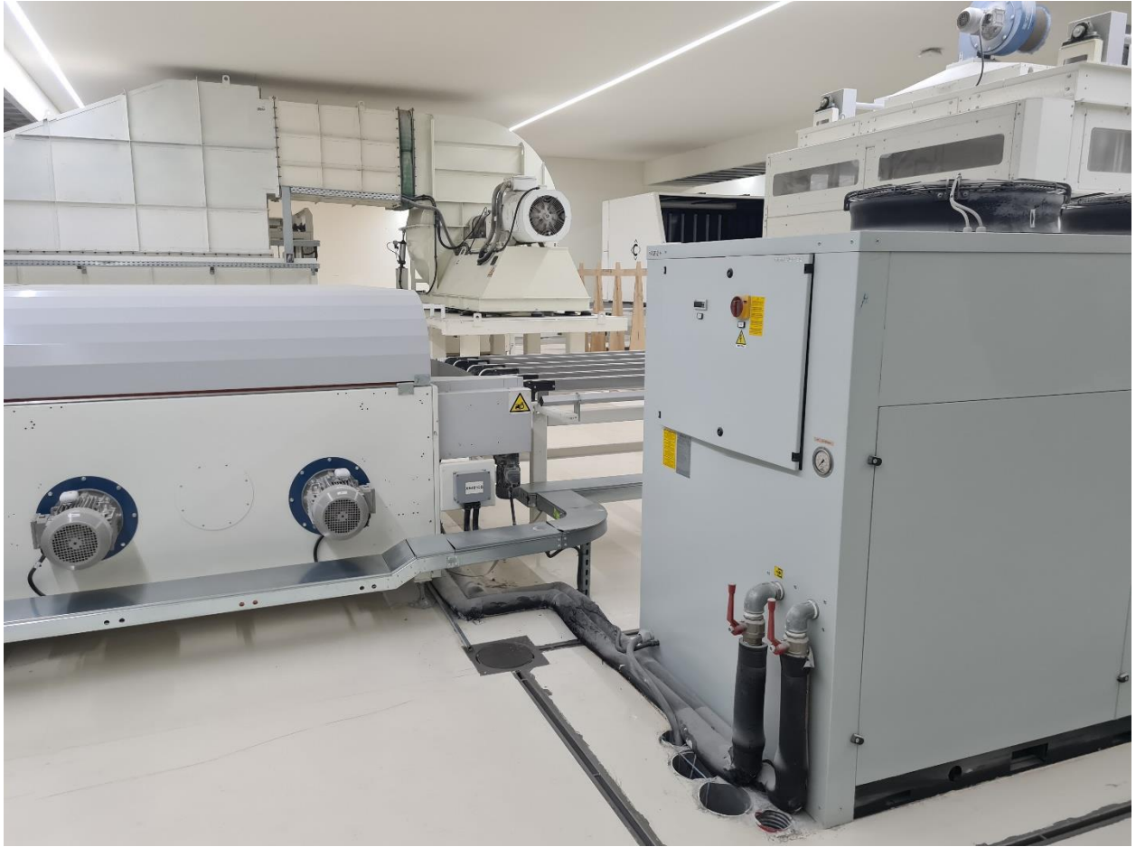
Figuur 20: Chiller zeefdrukinstallatie
