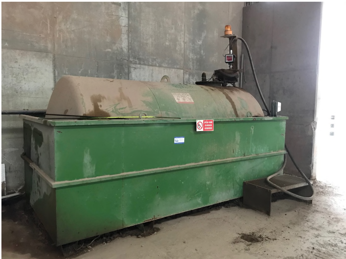
Bovengrondse tank T1 → boring B5001 + peilbuis P1001
