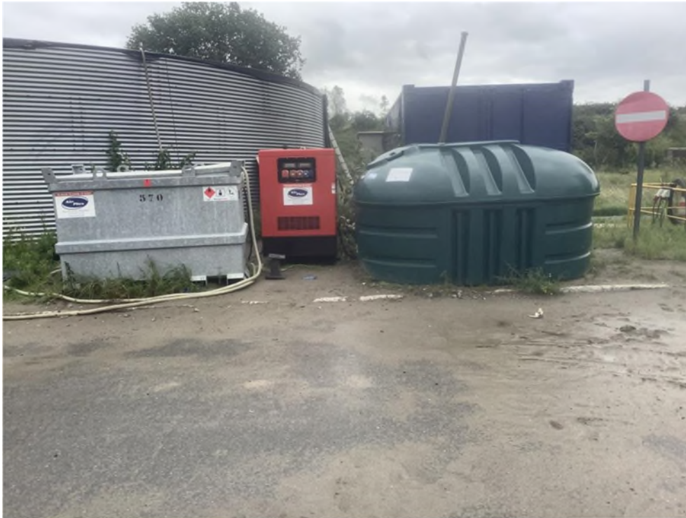
Tanks TR1 en TR2 ter hoogte van de waterzuiveringsinstallatie (peilbuis P2)
