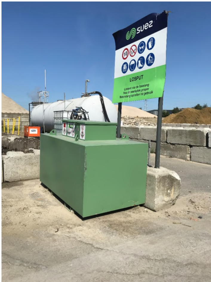
Tank TR3 (mobiel) (peilbuis P1)
