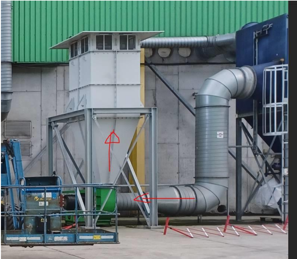
Figuur 4.4 Afzuiging filter (voor het behandelen van bodemassen)
