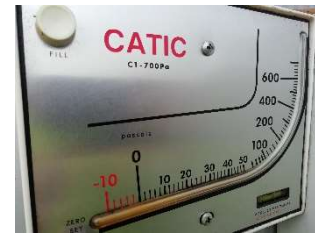
Foto van controle- systeem
