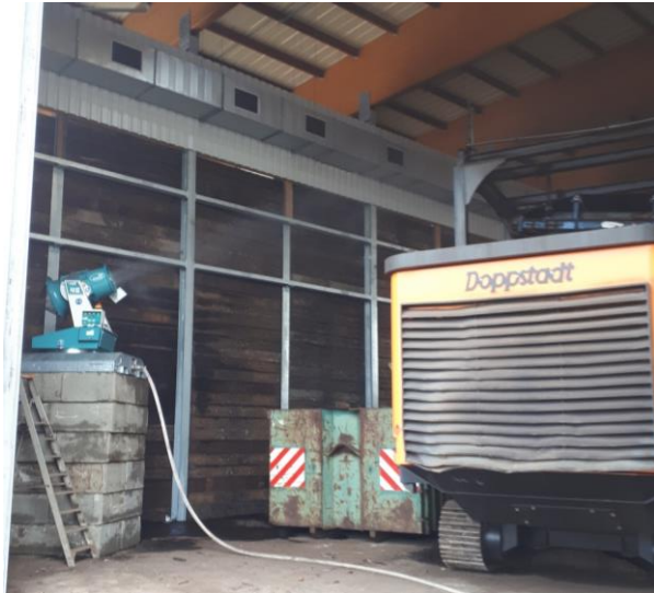
Figuur 1: Afzuiging en sproeiinstallatie
