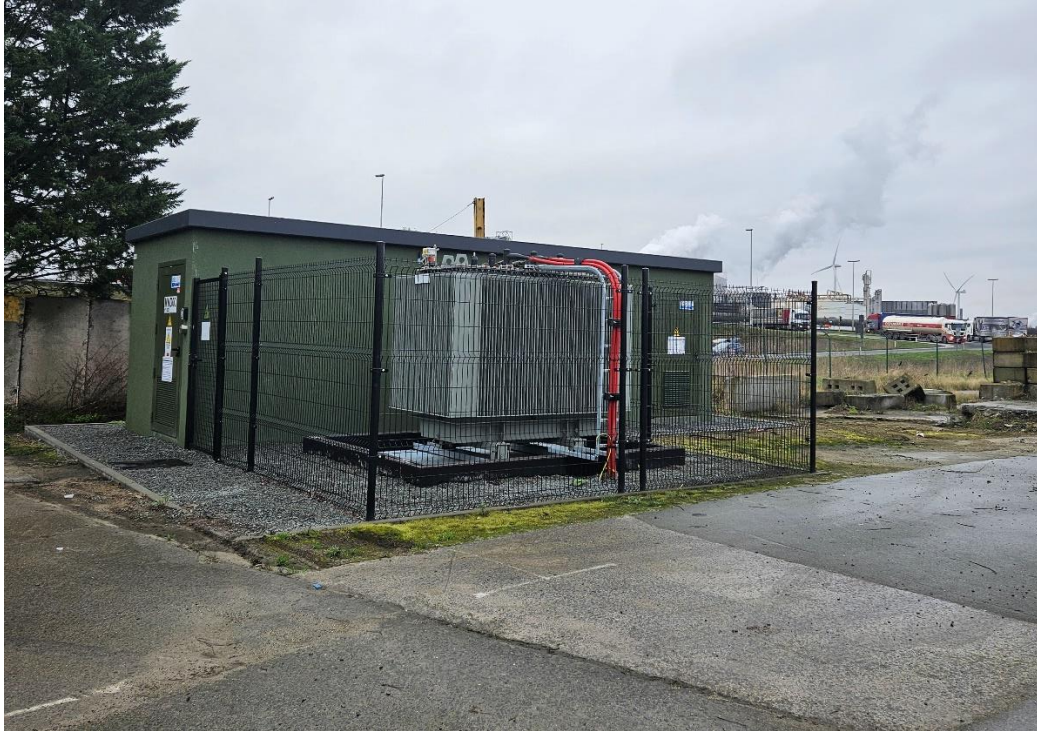
FIGUUR 2: HUIDIGE SITUATIE VAN DE TRANSFORMATOR EN AANSLUITINGSCABINE VAN HET PROJECT GENT HAVEN – MOERVAART NOORD
